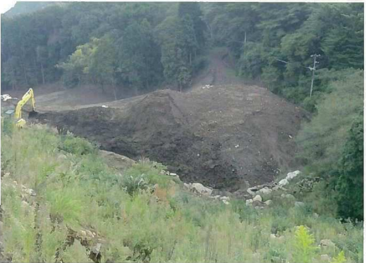
2010(平成22)年10月13日 調圧槽手前に大量の土砂を確認
