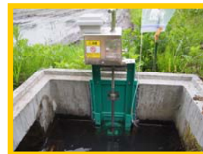
【水田自動水管理システム】
