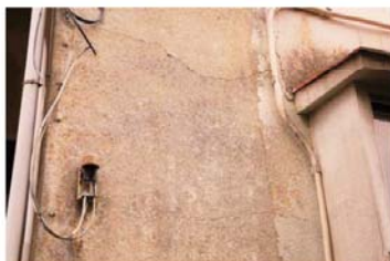
外壁のひび割れ ・コケ
