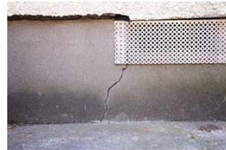
基礎のひび割れ
