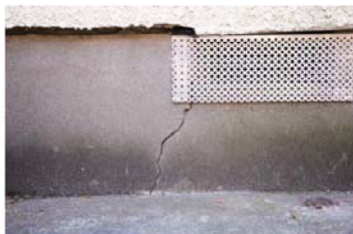
換気口付近の ひび割れ
