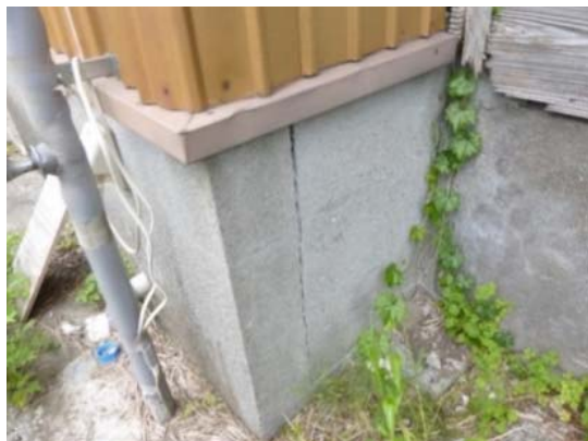
写真Ⅱ.2.3.3 基礎の割れ
