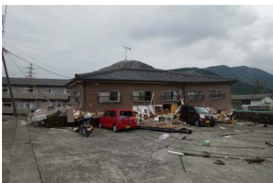
写真 14 倒壊した木造アパート
