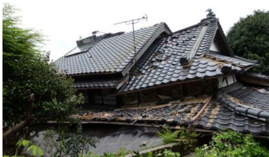
写真8 倒壊した木造住宅
