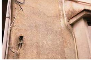
外壁のひび割れ・こけ
