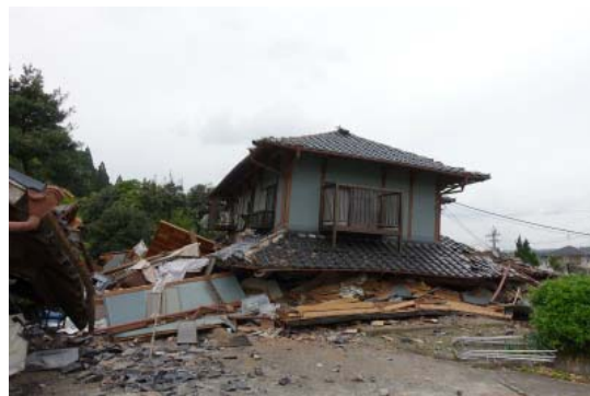
写真9 倒壊した木造住宅
