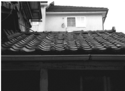
写真Ⅱ.2.3.1 屋根の波打ち (中央上部の屋根の棟線にたわみが見られる)
