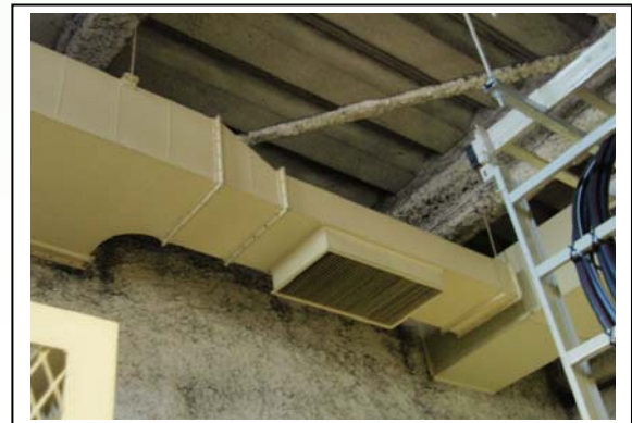
<第1電気室 空調>
