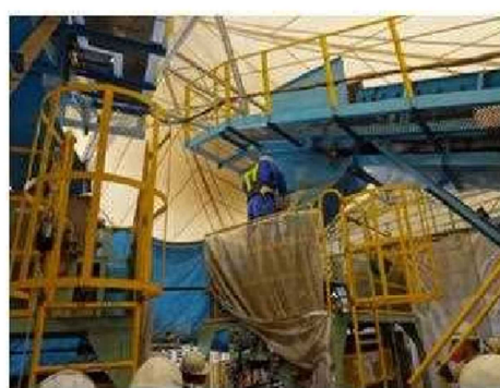
袋詰め供給コンベア
