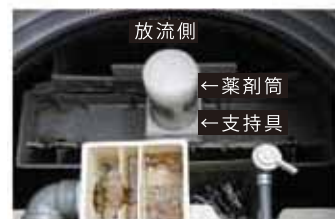
薬剤筒を確認 放流側に薬剤筒があります
