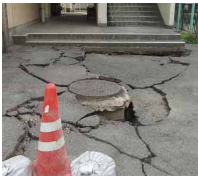
液状化で損壊したマンホール
