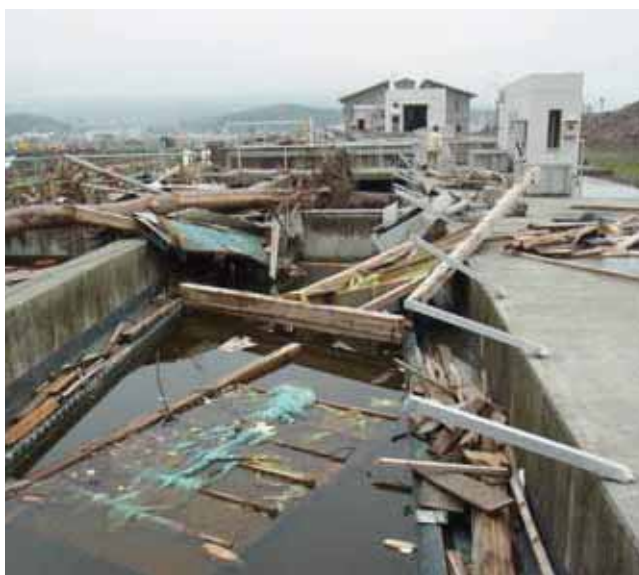
被災した汚水処理施設
