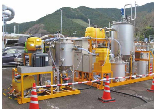
(左: 前処理装置 右: メタン発酵装置)
