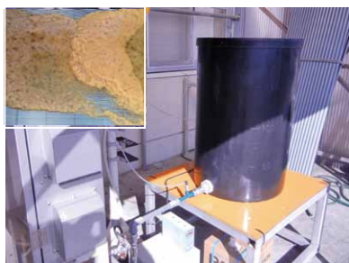
写真2 消化液固液分離装置
