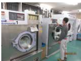
洗濯室/洗濯機
