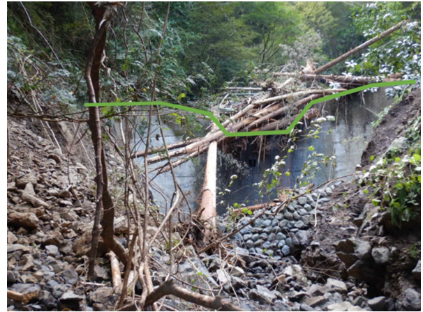
写真2 異状堆積した谷止工
