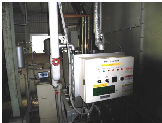
整備機械：過熱エンジン（過熱蒸気発生装置）
