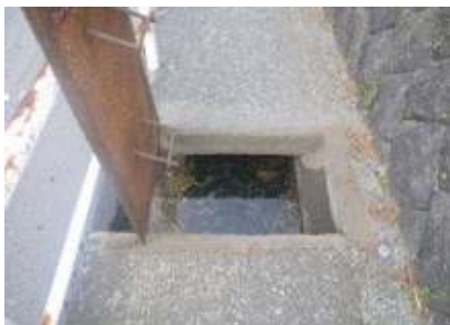
側溝(上流側)の満水状況
