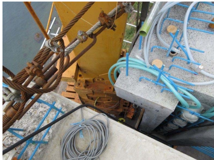
■ P 1 側門型油圧リフター基部（海側）
