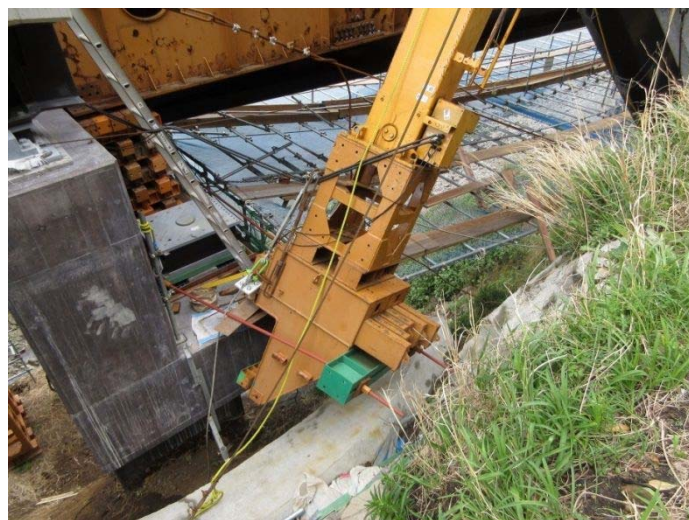
■ P 1 側門型油圧リフター基部（道路側）
