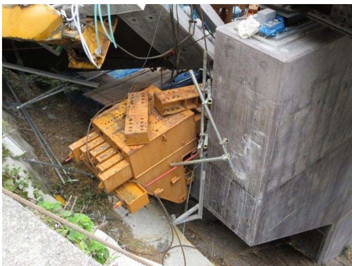
■ P 2 側門型油圧リフター基部（道路側）
