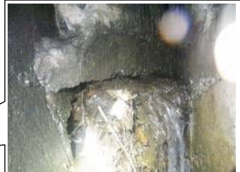
ごみが詰まっている状況
