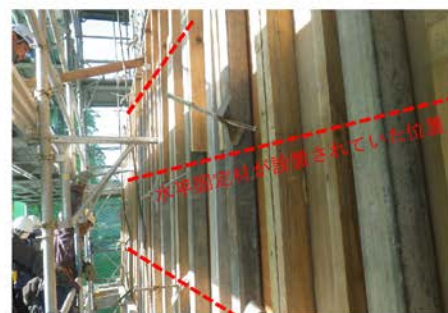
水平固定材が外れて落下した型枠
