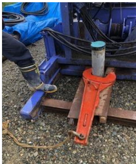
事故当時の固定状況
