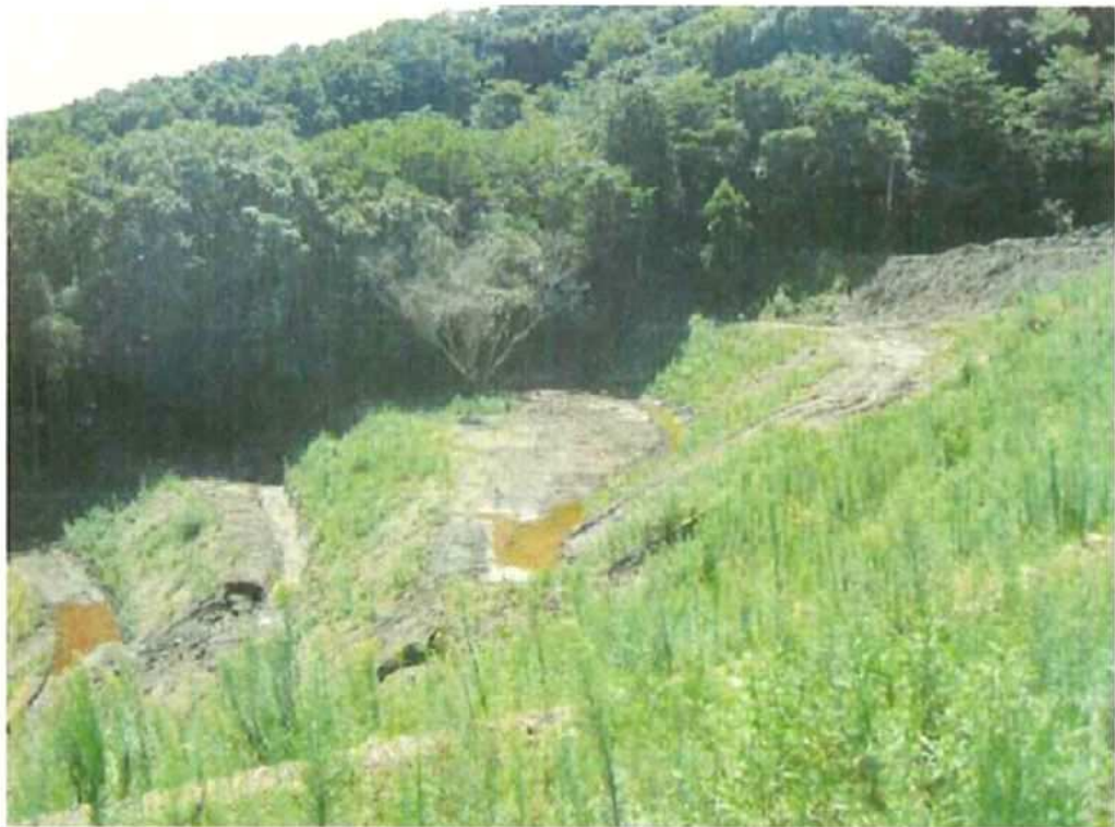
排水状況が悪く、小段の上に水たまり、左岸側に水みち、崩壊が見られる
