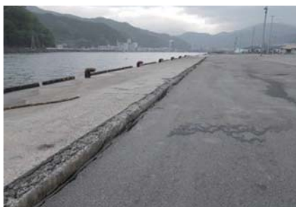
岸壁との段差状況
