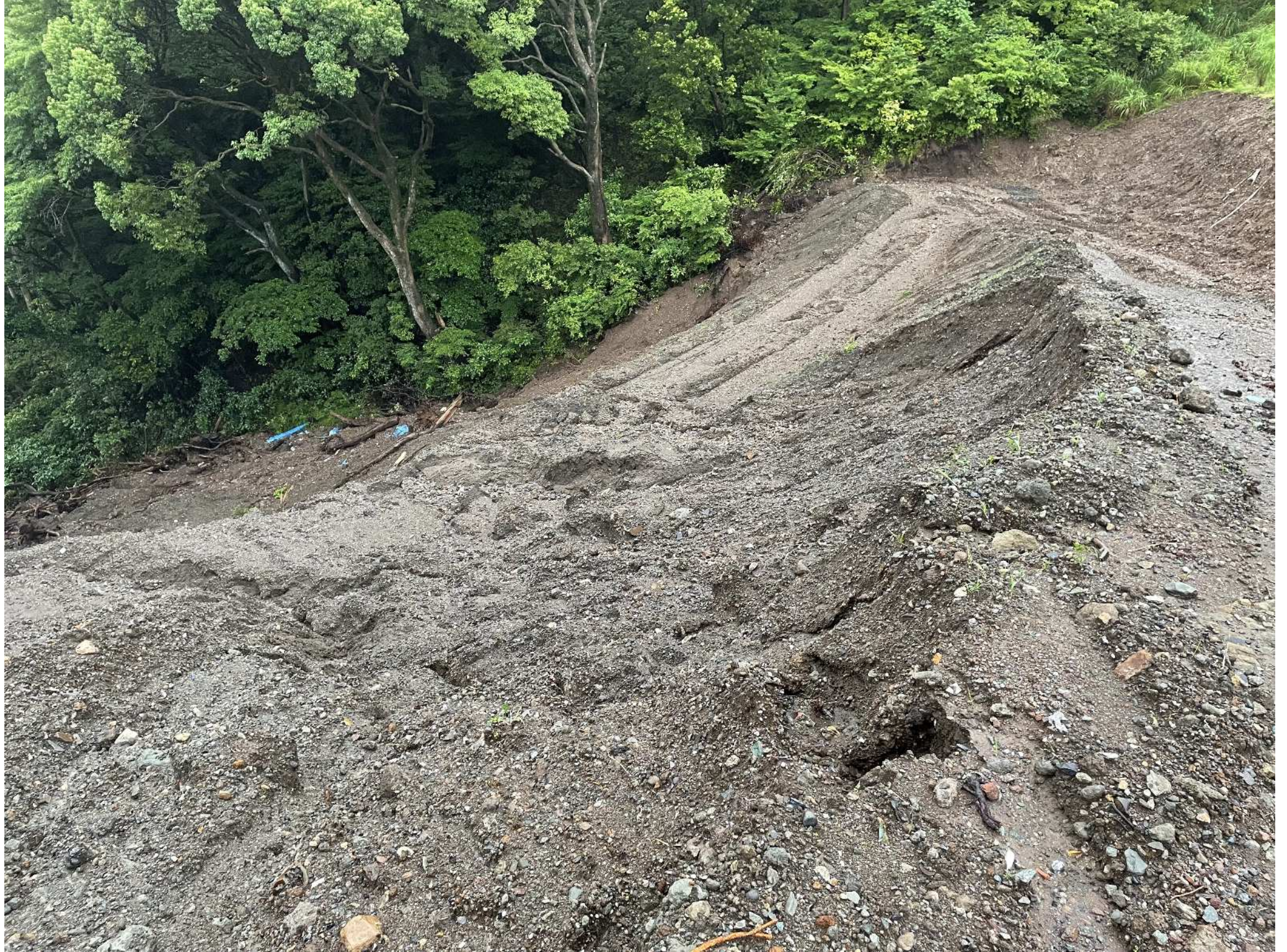
4崩壊地と太陽光発電施設南東下部斜面
