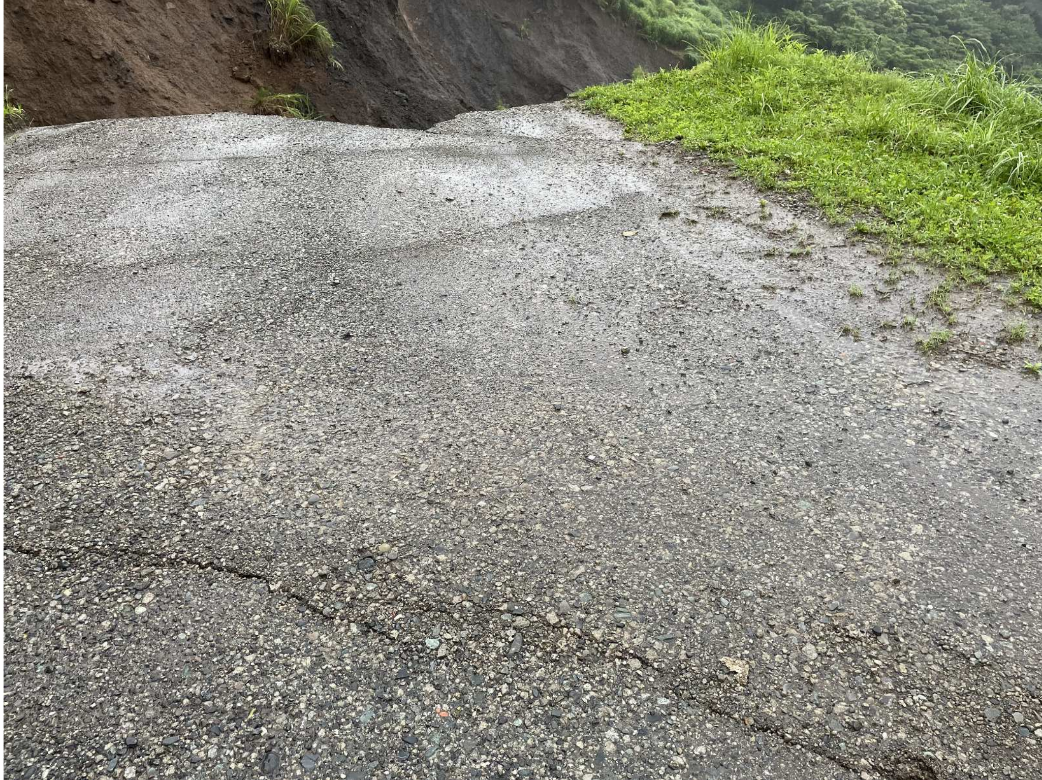
2逢初川源頭部右岸部クラック
