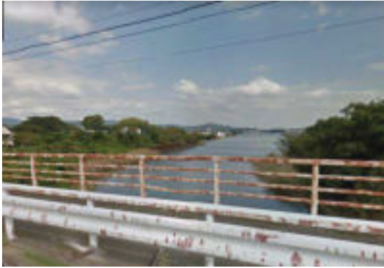
劣化して錆びた防護柵
