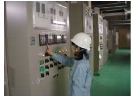
薬品注入設備の点検
