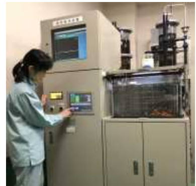
原水水質監視装置の保守作業
