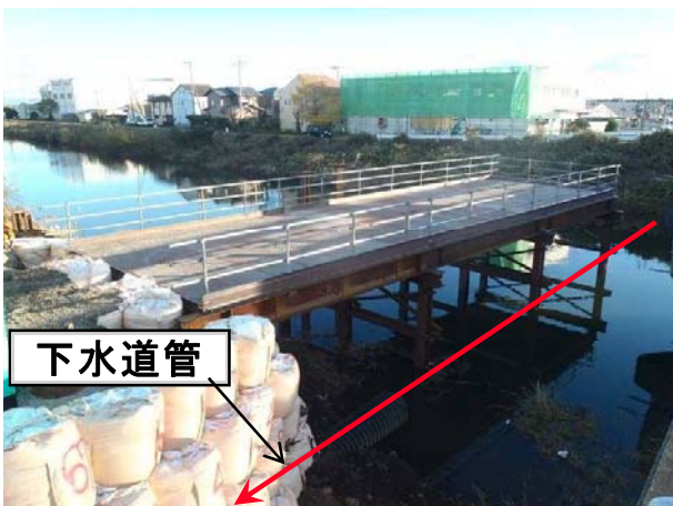
下水道管損傷箇所 西側から東側を望む
