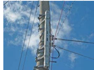
損傷した電柱(応急処置状況)
