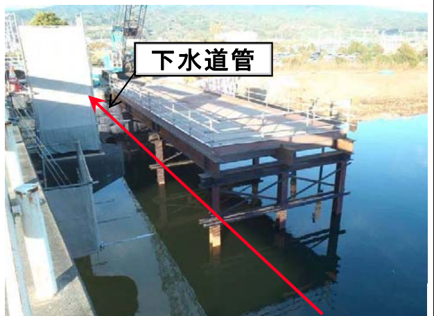
下水道管損傷箇所 南側から北側を望む
