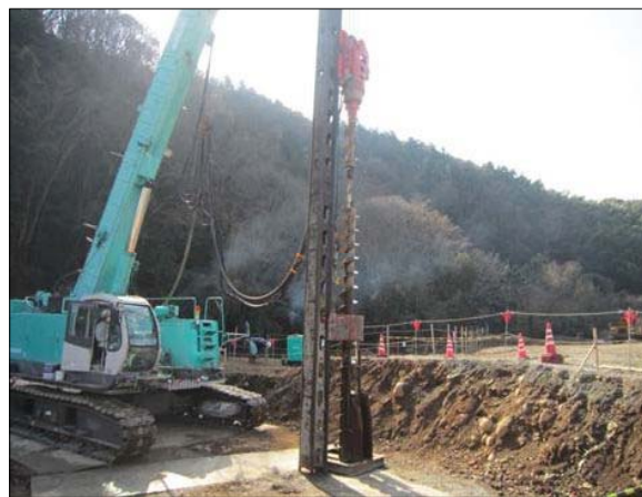
(写-4) 固定架台 (全景)
