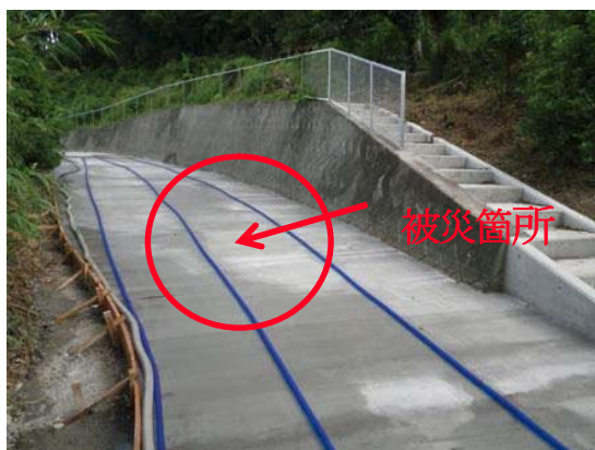
・事故現場写真
