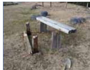
老朽化により破損したベンチ(H27年度当初)
