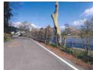
防護柵が単管パイプで出来ており、景観を阻害している(H27年度当初)
