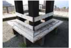
眺望点のベンチの劣化(平成29年度当初)
