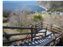
老朽化の進んだ階段(平成25年度当初)
