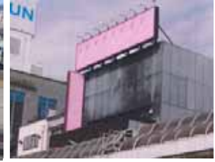
看板が壁面から突き出しており危険 (平成26年度当初)
