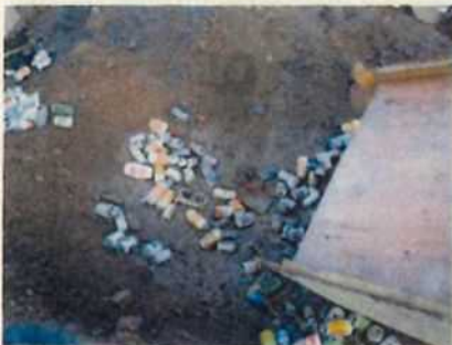
⑫ 空き缶散置状況
