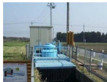
小水力発電所の整備
