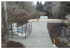
水源揚水井戸（御殿場市）
