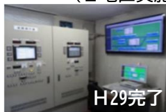
H29完了 管理システムの設置 (富士宮市大倉川ダム地区)
