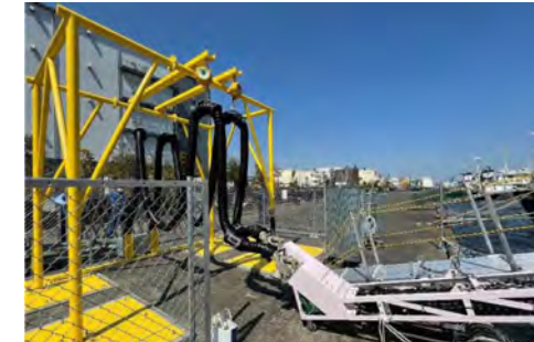
給電設備(川崎港)
