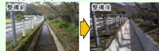
農業水利施設の保安全管理
