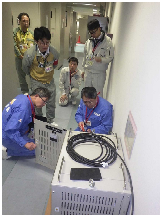
可搬型蓄電池据付け状況の点検の様子
