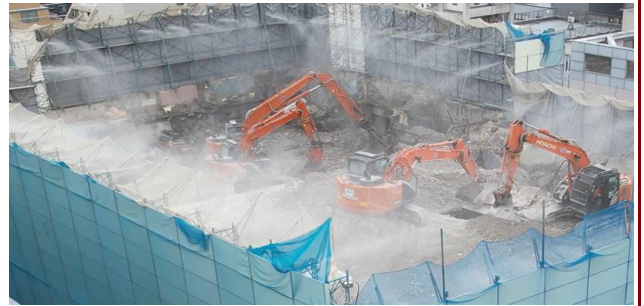
散水システム稼働状況(全体風景)
