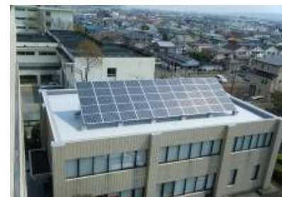
県有施設に設置された太陽光発電設備
