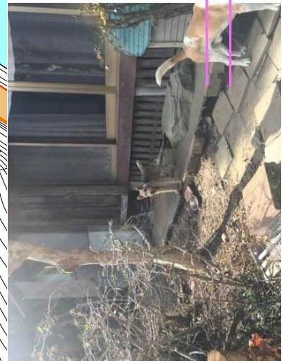
②土間の沈下状況
