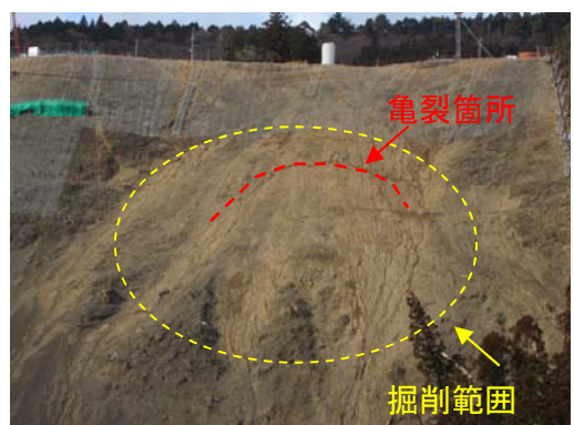
亀裂発生箇所(2月10日撮影)
