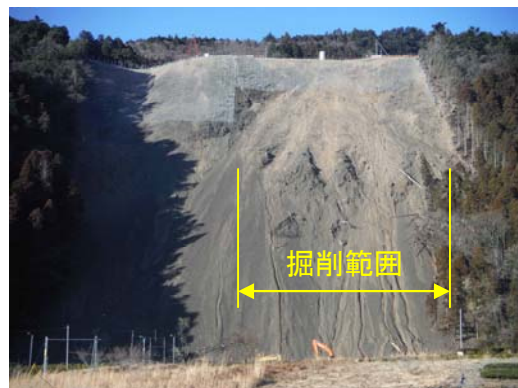
斜面全景(1月31日撮影)
