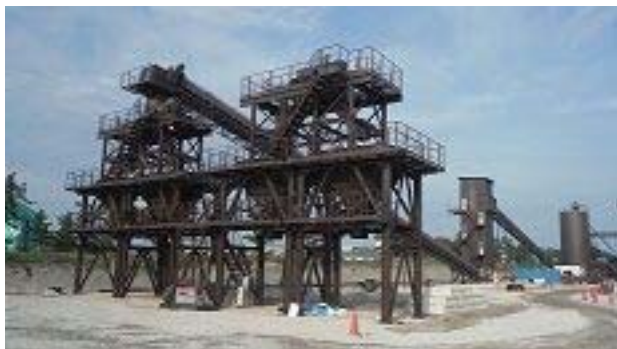
CSG製造プラント
