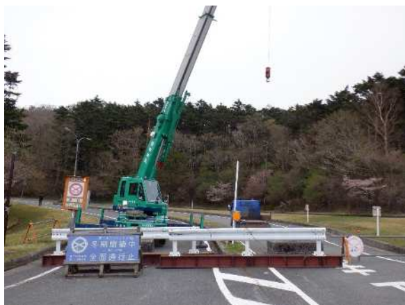
閉鎖状況（二合目）令和4年4月撮影
