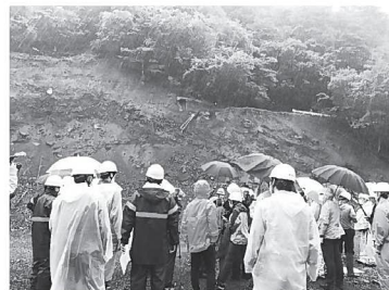
林道東俣線(崩落箇所)
