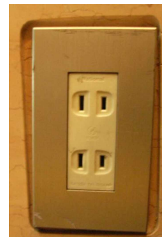
【写真7】別館商用回路コンセント例
