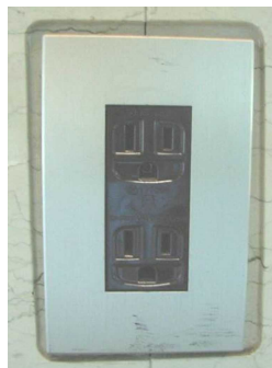
【写真6】別館発電機回路コンセント例
