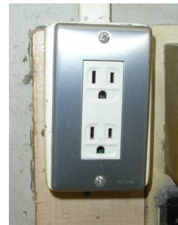
【写真5】西館商用回路コンセント例
