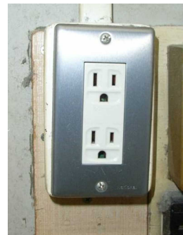
【写真5】西館商用回路コンセント例
