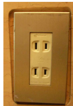
【写真7】別館商用回路コンセント例
