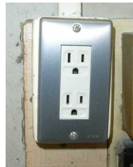
【写真5】西館商用回路コンセント例
