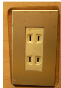
【写真7】別館商用回路コンセント例
