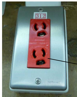
【写真4】西館発電機回路コンセント例
