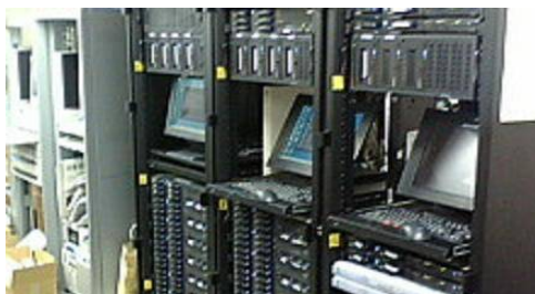
サーバ機器の集中化を進めています (イメージ)
