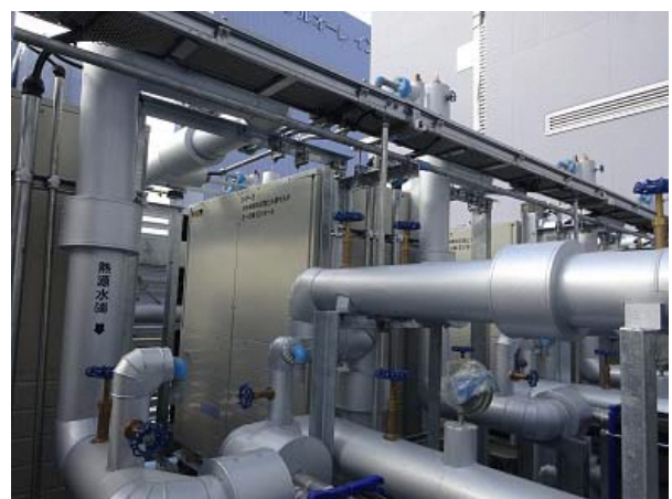
熱交換器設置状況
