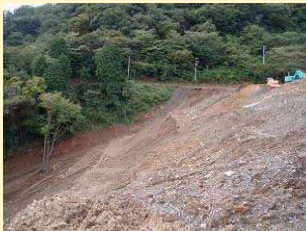
(不適切な盛土の例)
