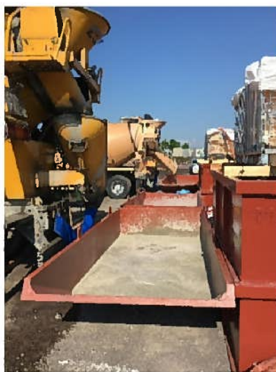
洗車設備の状況
