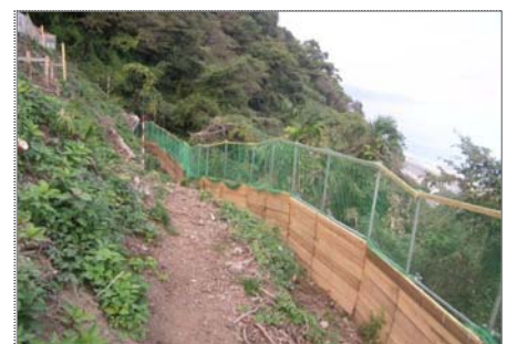
土砂流出防止柵
