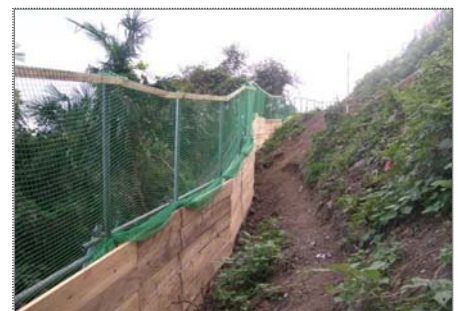
土砂流出防止柵
