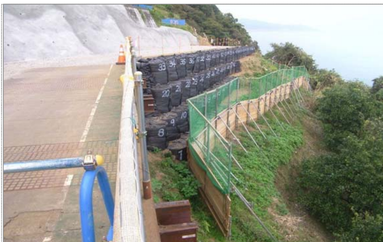
土砂流出防止柵
