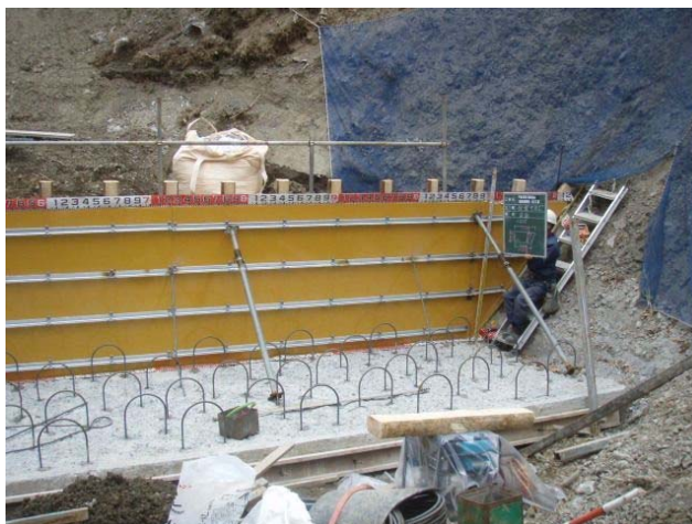
【内側からみた状況】太鼓材(t=9cm)を合板型枠に固定し設置
