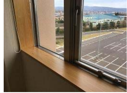
【貸し会議室の窓枠にも県産材を活用】
