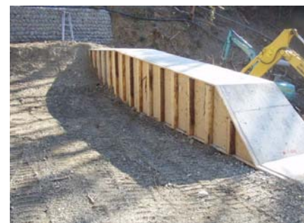
【上流側からみた型枠残置状況】
