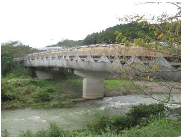
【全体設置状況】
