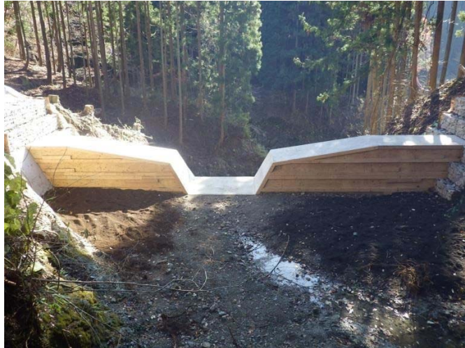
【カチオンフレーム工法(県産材合板仕様) 谷止工完成時】 合板に加え平割材も使用しているため木材利用量が向上
