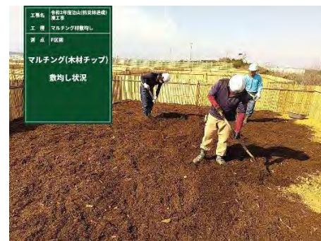
【設置状況(近景)】
