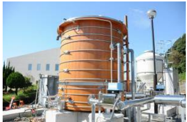
【木製受水槽】天竜スギで作られた受水槽
