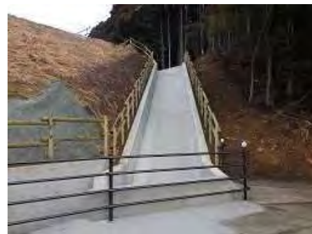
【余水吐に設置した木柵】
