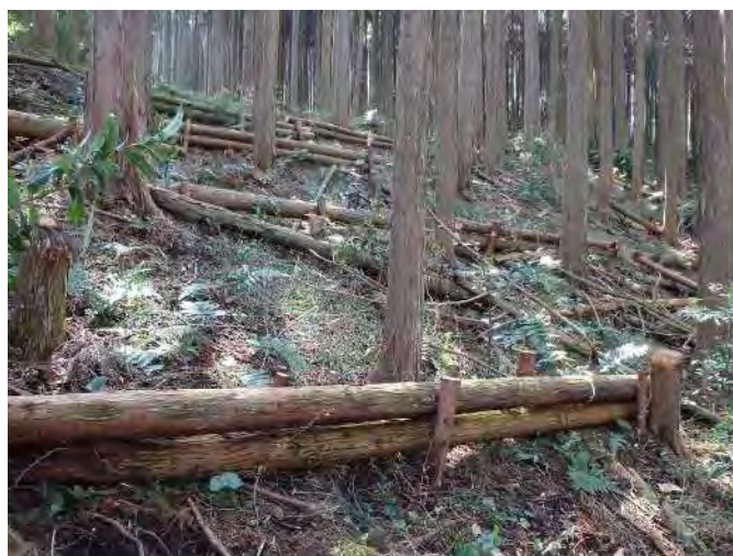
【土砂流出防止柵】
