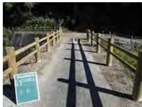
【ため池堤防天端に設置した転落防止柵②】
