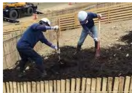
【設置状況(近景)】
