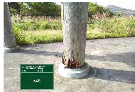
【着工前腐朽状況(主柱)】
