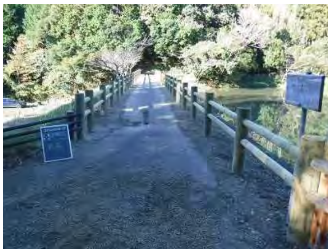
【ため池堤防天端に設置した転落防止柵①】
