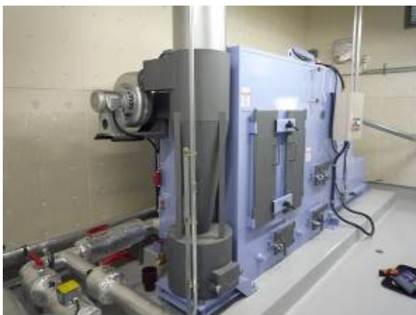
【木質ペレットボイラー】
