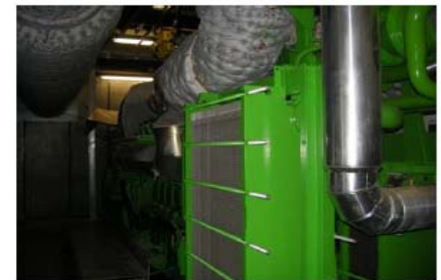
天然ガスエンジンにより、熱、電気、CO 2 を利用するトリジェネレーションシステムを導入
